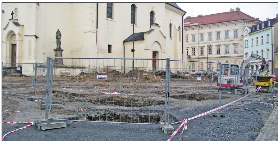
Obr. 2. Příbram, náměstí T. G. M., duben 2012. Plocha s výzkumem části novověkého hřbitova u kostela sv. Jakuba Staršího (vlevo) s výkopem pro ukotvení vánočního stromu. Nehlášenými výkopovými pracemi byla těžce poškozena též studna, patrně středověkého stáří. Foto R. Korený.
